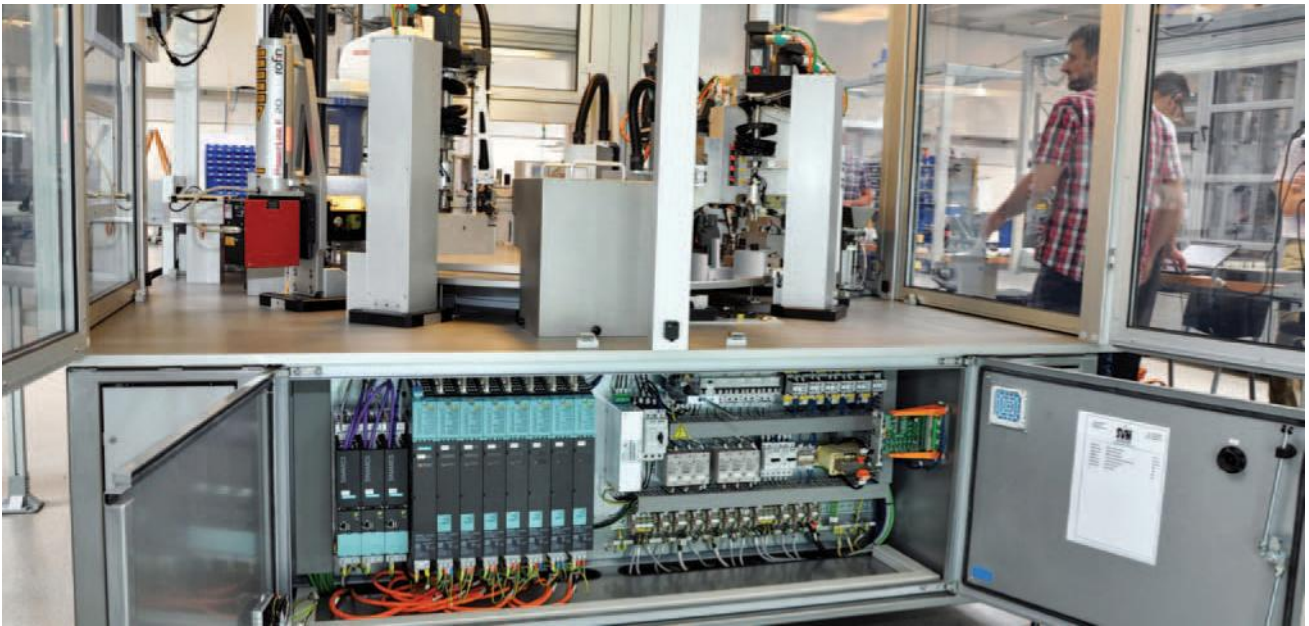
Celle 3 med rundbordet øverst og styringen i tavlen nedenunder. For at forenkle reservedelslageret på fabrikken i Asien er der såvidt muligt brugt de samme servodrev, PLC'er og andre enheder til de forskellige funktioner.
