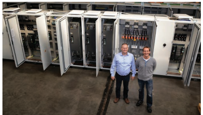
Fra venstre: Projektleder Lars Hansen fra Dan-Web og Peter Hyldgaard fra PD Automation foran de to rækker af tavler, der indeholder styringen af det nye produktionsanlæg til papirfibre.
