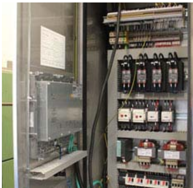
Åben styretavle med bagsiden af panel-pc'en.
