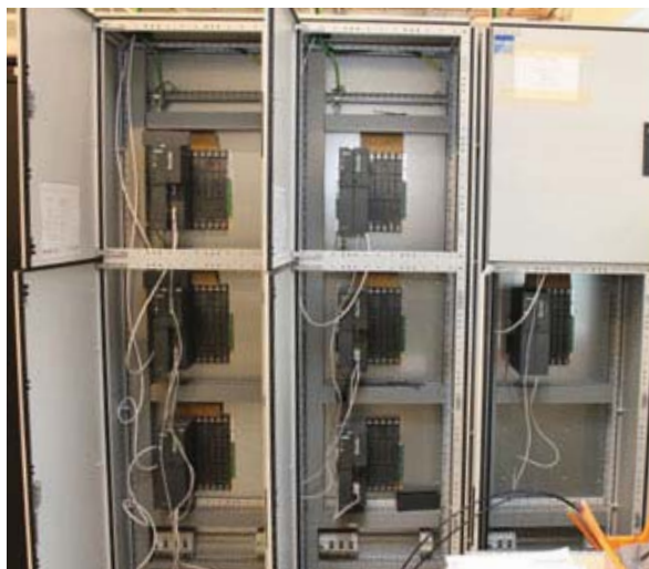
Det er ikke hver dag, man ser 7 stk. PLC'er i samme tavle. Da anlægget er under idriftsætning, er der endnu en del løsthængende kabler.
