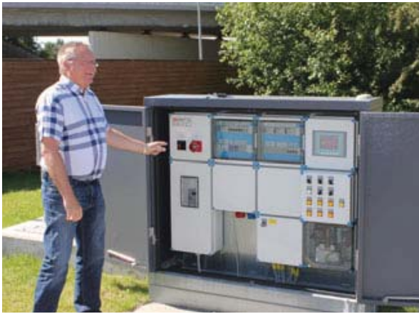
Modsat side: S7-1200 PLC-styringen. Øverst til venstre: Direktør Leif Tångberg fra Tångberg Pro-Consult viser en nyrenoveret pumpestation frem. Nederst til højre: Spildevandcenter Avedøre.
