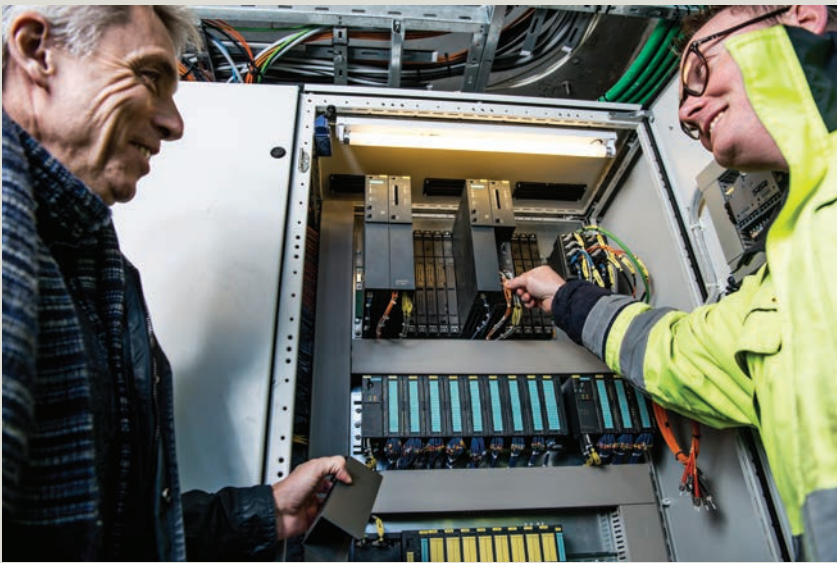
Rasmus Kvistgård (til venstre), projektleder hos SH Group, viser Jens Norling Mathiassen, projektchef i Siemens, teknikskabet, hvorfra Siemens redundante S7-400H CPU styrer Proviantsbroen og Trangravsbroen på Christianshavn.
